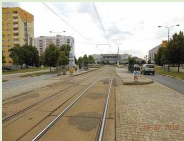
Deformace tramvajových kolejí: nahoře v ulici Koterovské, dole v ulici Plaské.
